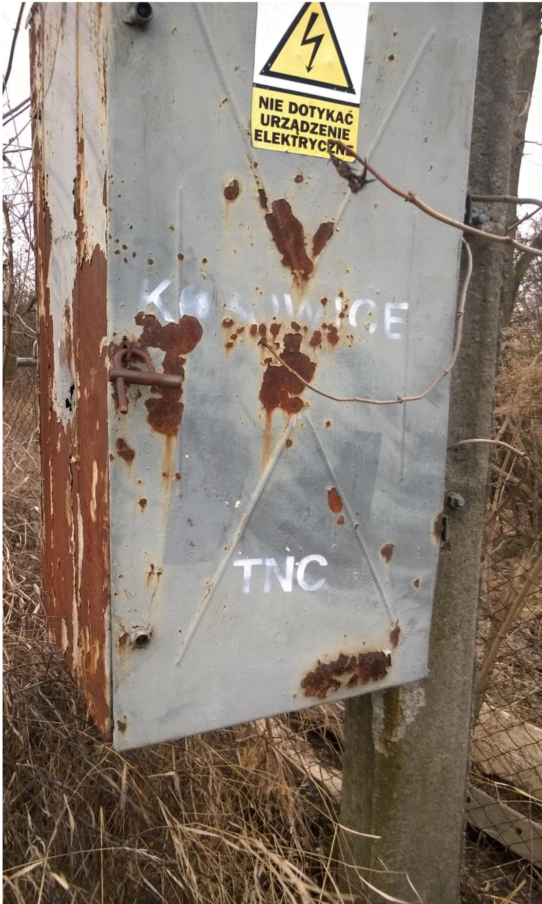
Przykład skorodowanej stacji transformatorowej z szafką zakwalifikowaną do wyniesienia ( Kosowice 4)
