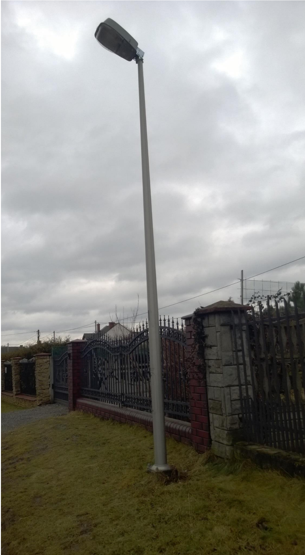
Przykład słupa z oprawą na nowo wybudowanej linii kablowej oświetlenia ulicznego (Świrna)
