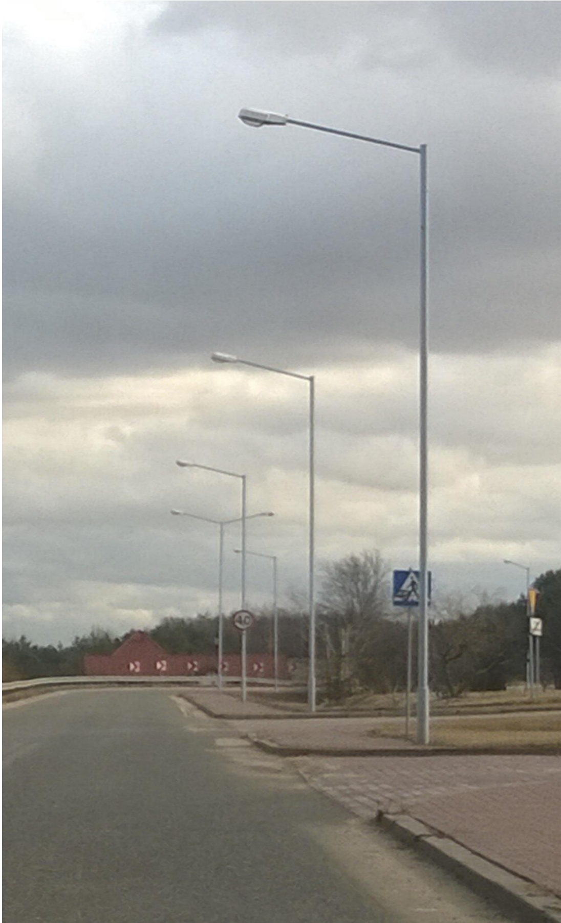
Przykład rozstawienia kablowej sieci oświetlenia (Chmielów) ECO ENERGY POLAND Mariusz Staniek Cieszyn 43-400 ul. Górna 29B Tel. 33 444 73 23 Tel. kom. 663 285 231
