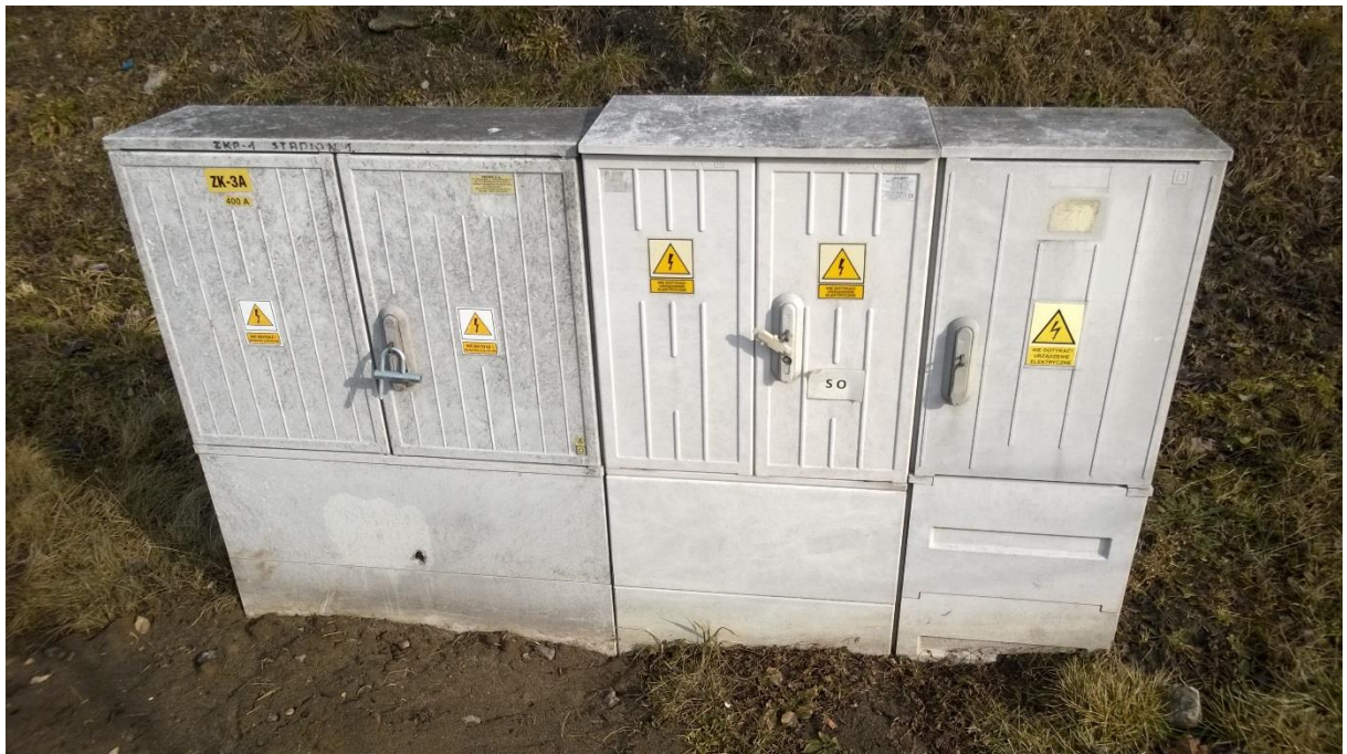
Przykład kablowej szafki oświetleniowej SOK (Bodzechów stadion)
