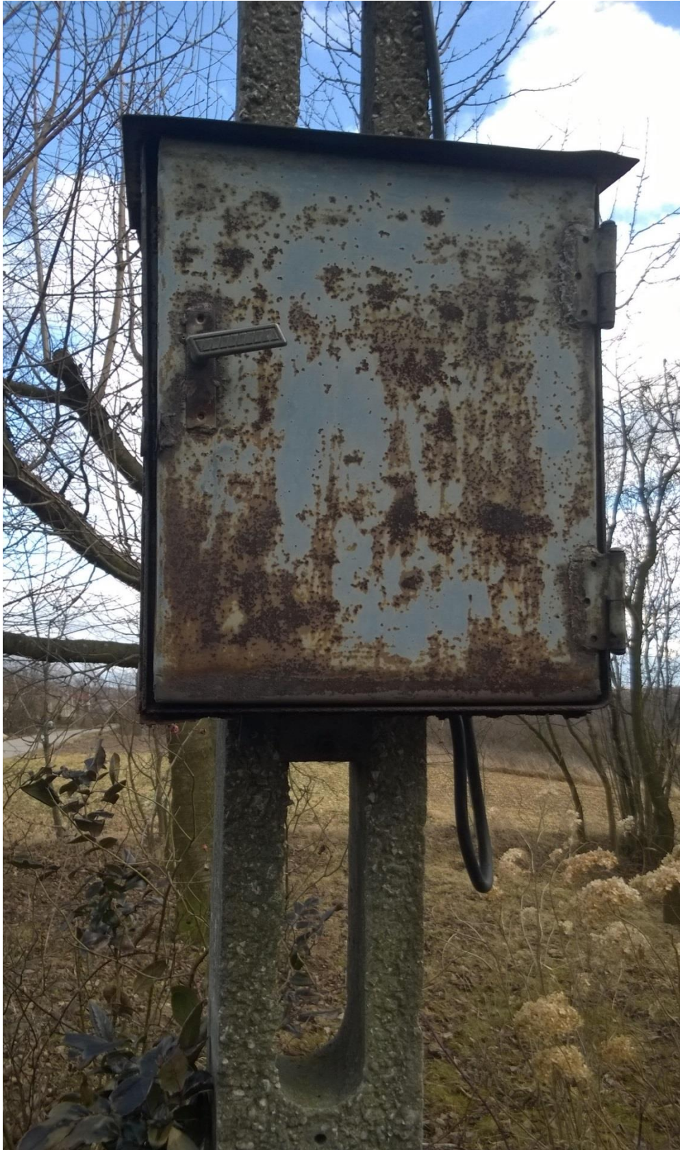
Przykład skorodowanej metalowej szafki oświetleniowej (Mirkowice Gromadzice 3)
