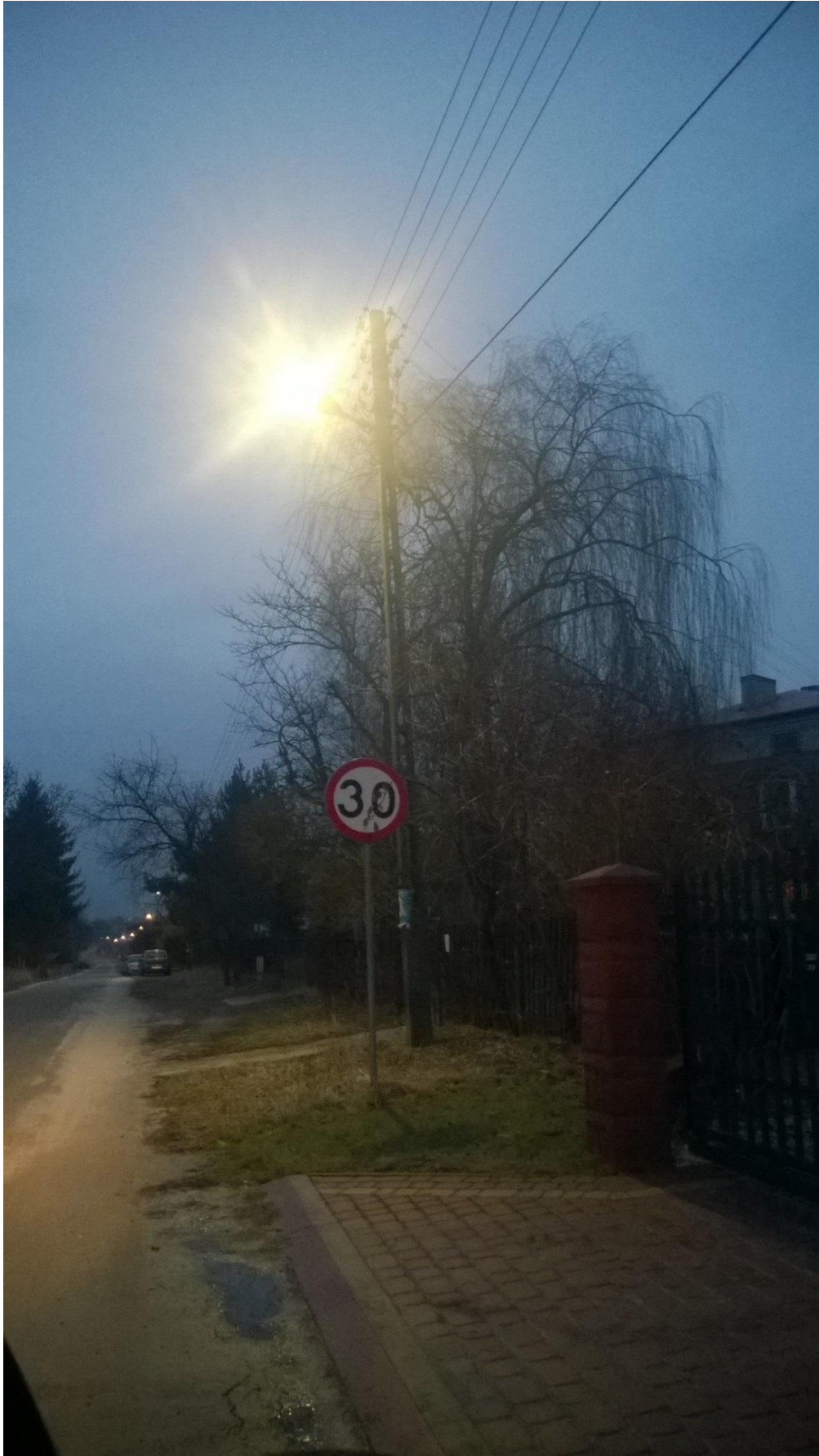
Przykład oświetlenia drogi linią napowietrzną (Szewna)
