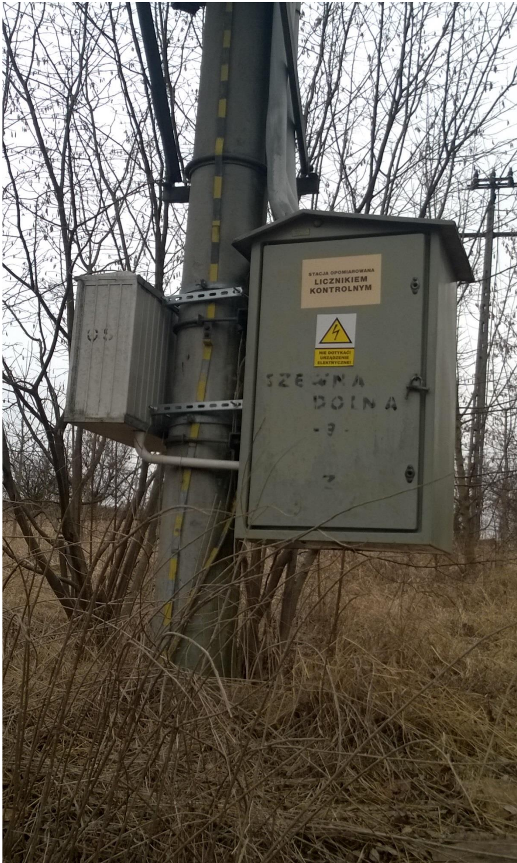
Przykład wyniesionej szafki oświetleniowej ze stacji trafo (Szewna Dolna 3)
