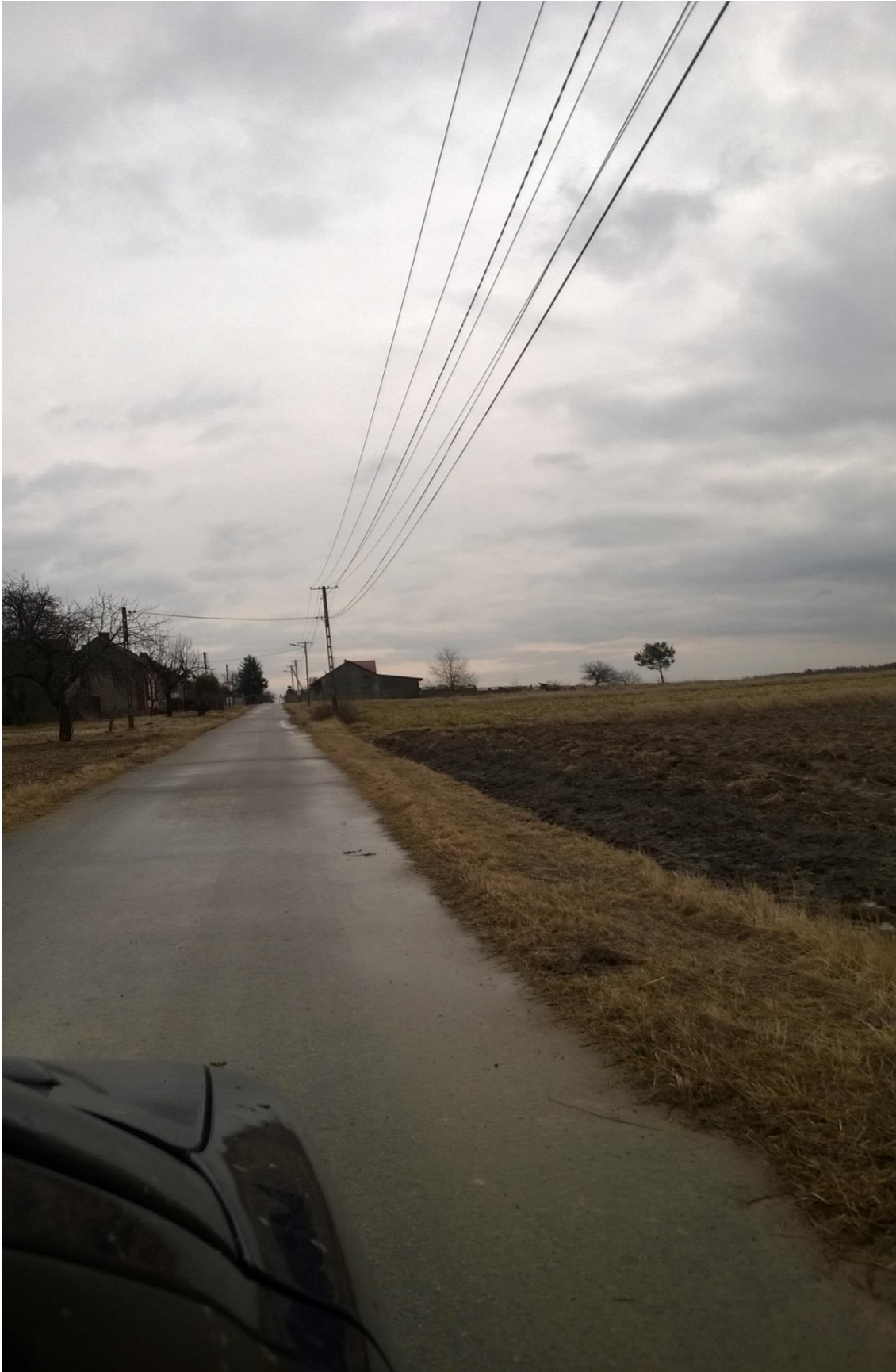
Przykład napowietrznej linii oświetlenia na sieci skojarzonej zakładu energetycznego.
